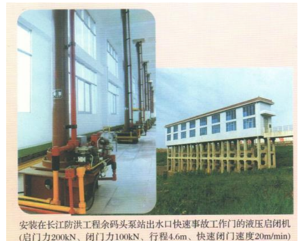
长江防洪工程嘉鱼余码头泵站（QPKY 系列）
