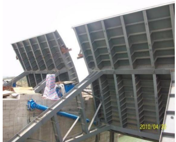
江西下坊水电站（QHLY 系列）
